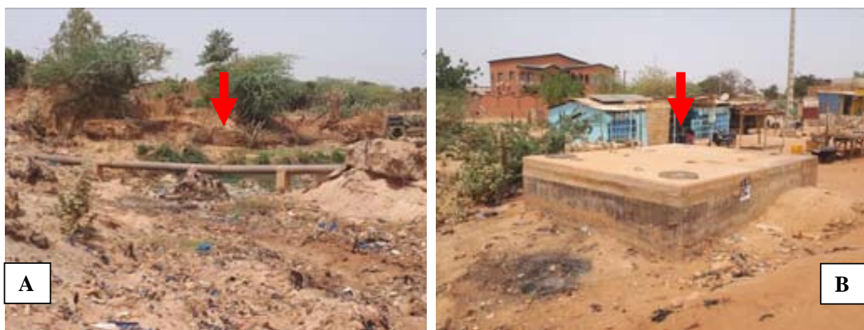
Photo 25: Aperçus d'une canalisation de l'ONEA traversant le marigot de Goudrin (A) et d'un regard de l'ONEA aux environs de l'affluent 2.
